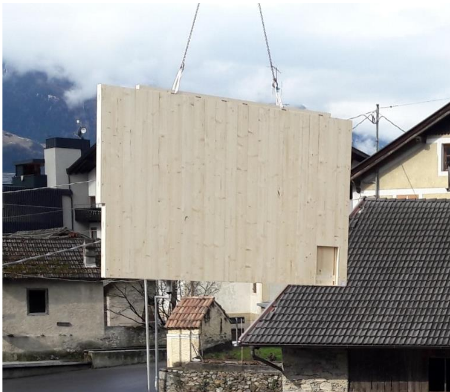
Abbildung 6: An den Einwegschlaufen kann die Wand angehoben und zum Montageplatz transportiert werden.
