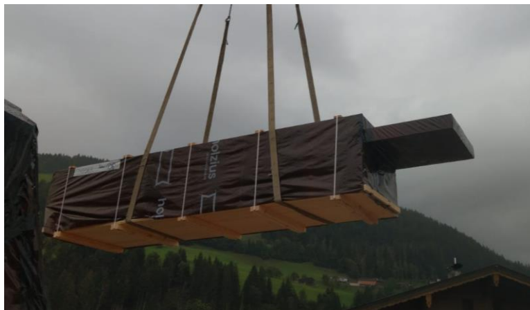
Abbildung 10: Das Paket mit Vollholzdecken wird mit ausreichend starken Gurten angehoben und an den Standplatz gestellt.
